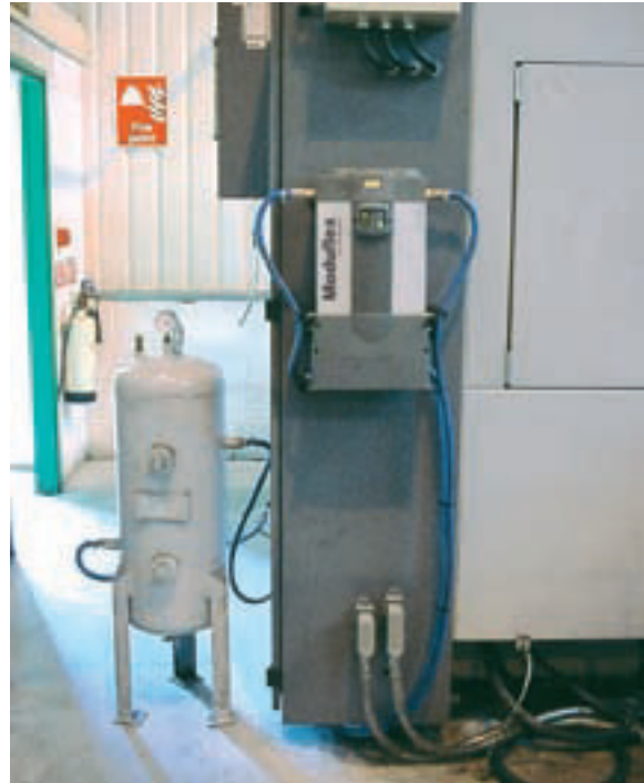
Moduflex Drucklufttrockner für die Steuerluft einer CNC-Drehmaschine
